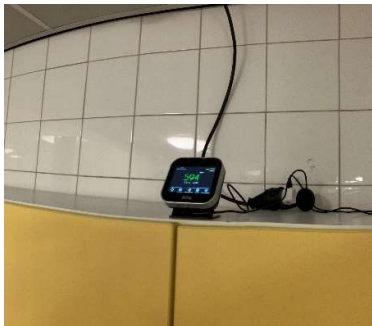
Figuur 28 AirTeq binnenklimaatmeter in kleedruimte zwembad
